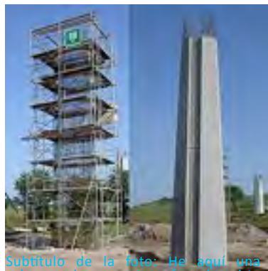
Subtítulo de la foto: He aquí una columna de concreto reforzado, visto antes y después del concreto haber sido vertido en su sitio alrededor de la jaula con barras reforzadoras.
